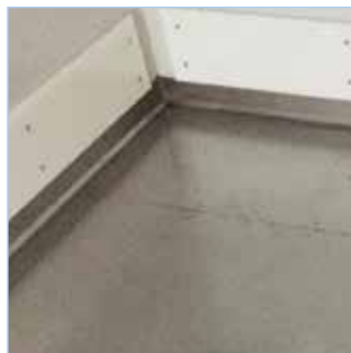
HACCP-Standard, rutschfester Edelstahlboden
