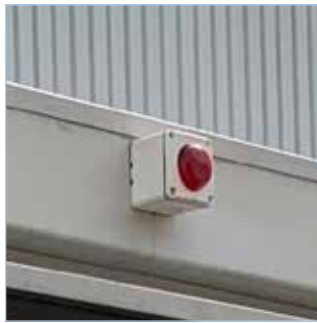
optisch und akustischer Alarm
