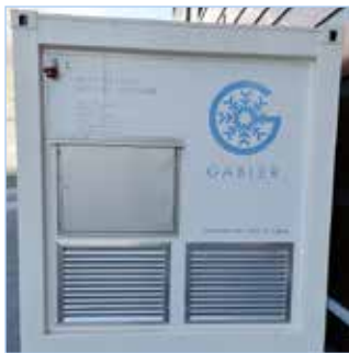
integrierte Kälte- und Elektrotechnik
