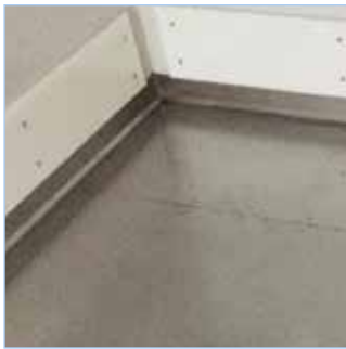
HACCP-Standard, rutschfester Edelstahlboden
